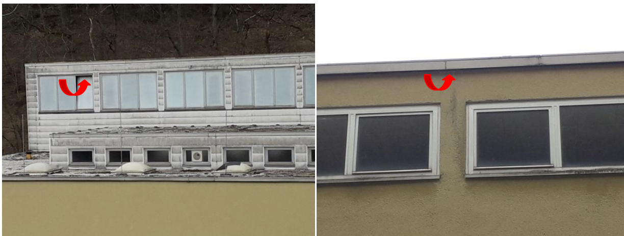
Abb.: Beispiele für potentiell geeignete Quartiere gebäudebewohnender Vögel und Fledermäuse (eigene Aufnahmen, bearbeitet, 03.04.2020)
